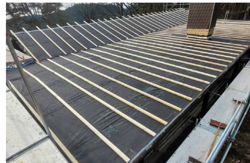
Die neue Dachbahn statt des alten Unterbaus mit Bitumen ist verlegt. Foto: Thomas Kilian
